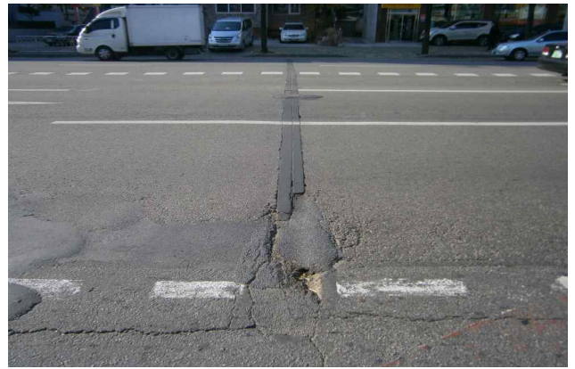
No. 28 신축이음장치 포장 보수부 주변 손상확대
