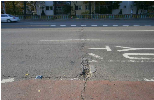
No. 51 신축이음부 ASP 오버레이 - 균열발생
